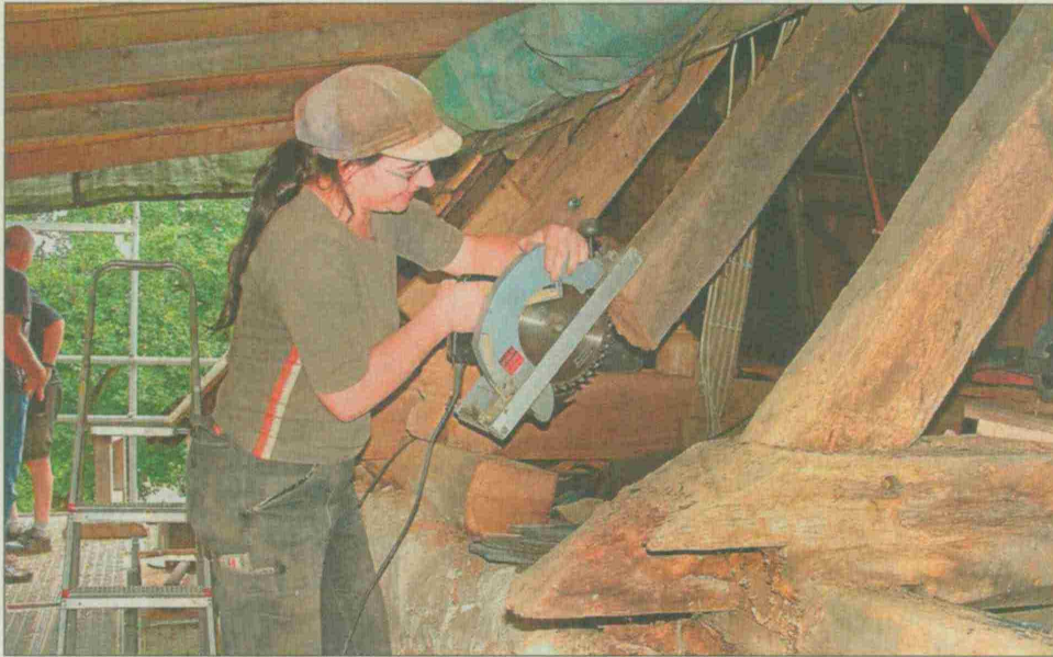
Morsche Dachbalken tauscht Roswitha Schwalbach von der Zimmererei "Fachwerk" aus Münchhausen-Wollmar zur Zeit an der Hufeisenkirche in Altenvers aus. (Foto: Hemberger)
